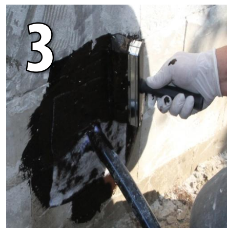
3 Une fois le Geotextile mis en place, remettre une couche de HBS-200
